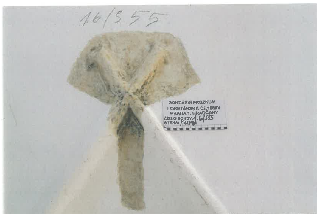
Prostor č. 1.6 (Průjezd) - Sonda č. 55. Štukové členění klenby pochází z nejstarší stavební fáze a souvisí tedy s malířskou výzdobou na povrchu jejich kletovaných omítek.
