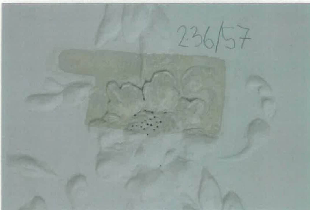
Místnost č. 2.36 – strop, východní část. Sonda ve vrstvách novodobých monochromních nátěrů, které značně deformují modelaci původních štukatur.
