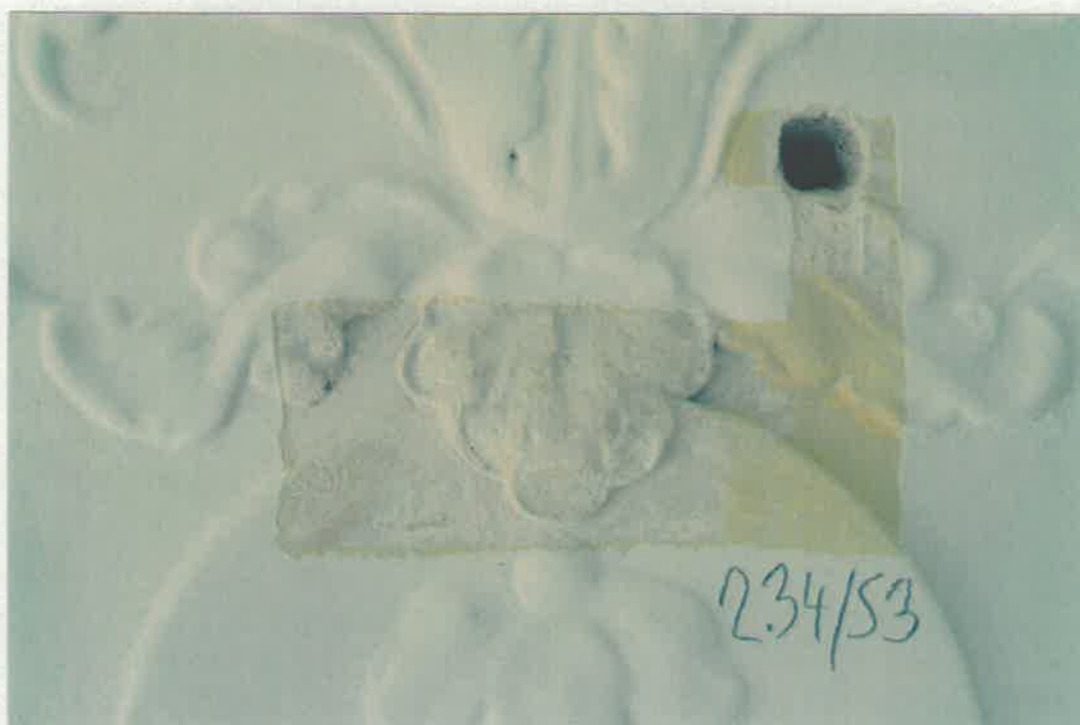
Místnost č. 2.34 – sonda S3, nalevo je odkrytý povrch štukatury, poškozené v minulosti rasantním mechanickým čištěním (chybí závěrečná povrchová úprava).
