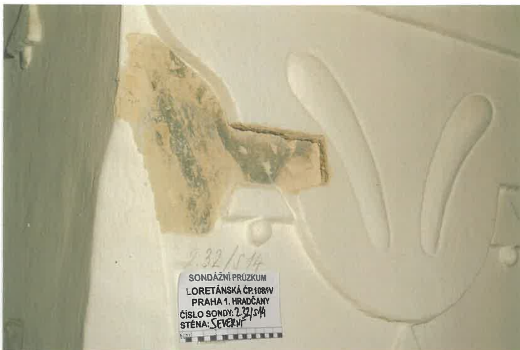
Prostor č. 2.32 - Sonda č. 14 na centrálním pilíři schodiště. Pod mladší štukaturou malované dekorativní malované členění na kletované omítce.
