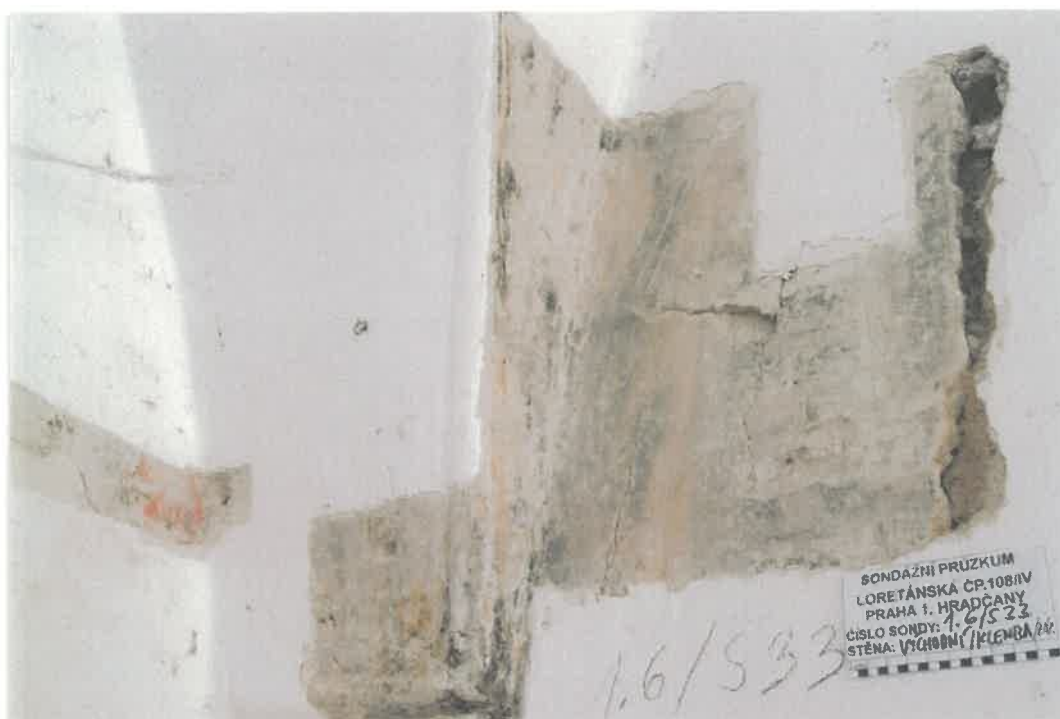
Prostor č. 1.6 (Průjezd) - Sonda č. 33. Při odkrytí větší plochy je manýristická dekorativní malba poměrně dobře čitelná.
