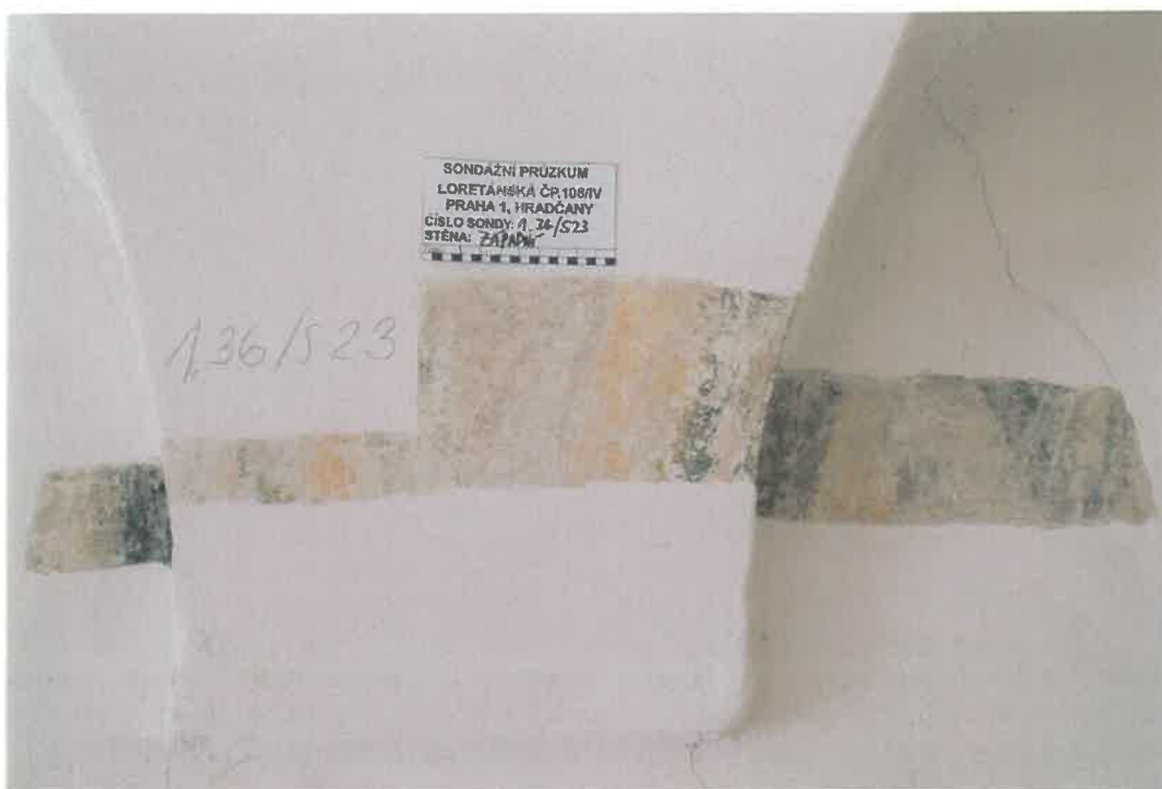
Místnost č. 1.36 - Sonda č. 23 dokládá přítomnost malířské výzdoby poškozené škrabáním. Základní barevný a tvarový rozvrh dekorace je navzdory poškození čitelný.
