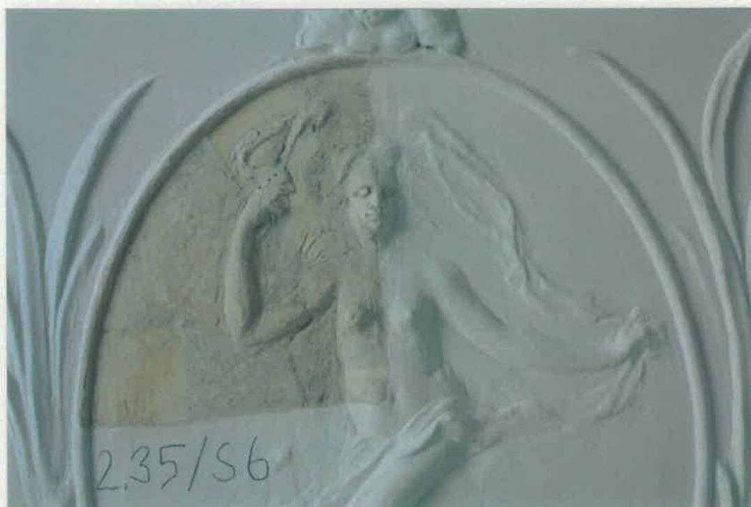
Místnost č. 2.35 – strop, sonda S6. Na povrchu původní povrchové úpravy (tenký vápenný nátěr v barvě slonové kosti) jsou zbytky špatně odstraněných nepůvodních nátěrů v barvě šedo zelené.
