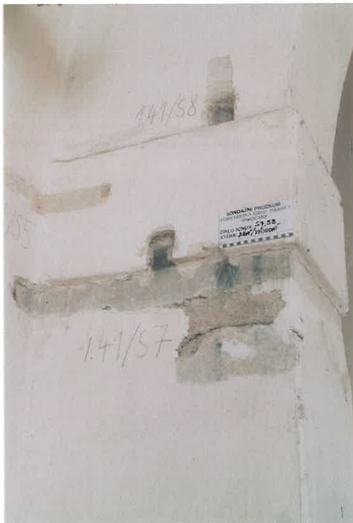
Prostor č. 1.41 - Sondy č. 7 a 8. Sonda č. 7 dokládá, že ve fázi manýristické dekorativní výmalby nebyl štukový pásek v doběhu klenutí arkády na kolmé stěně (v patce) přítomen.
