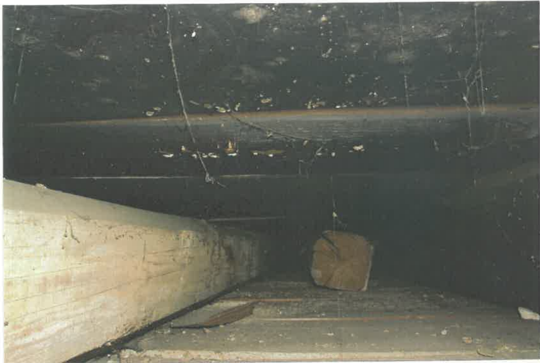
Místnost č. 2.28 - Dřevěný malovaný záklopový strop poškozený dehtovými zplodinami při úniku kouře do meziprostoru nad barokním podhledem z dřevěho komína ve stěně mezi m. č. 2.28 a 2.33.
