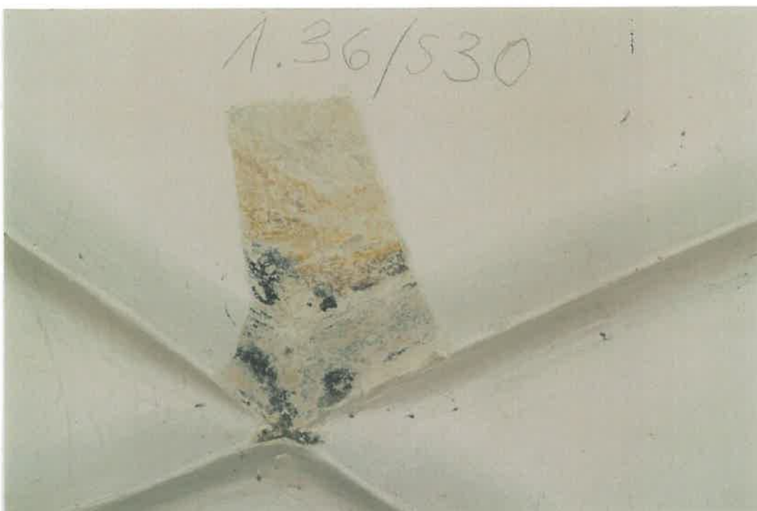
Místnost č. 1.36 - Sonda č. 30 provedená v křížení hřebínků na klenbě dokládá přítomnost nejstarší malířské výzdoby poškozené škrabáním na povrchu kletovaných omítek.
