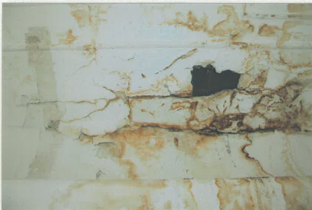
Místnost č. 2.34 – centrální část jižního fabionu, destrukce rákosových armatur a dřeva nosných konstrukcí v důsledku opakovaného zatékání dešťové vody.
