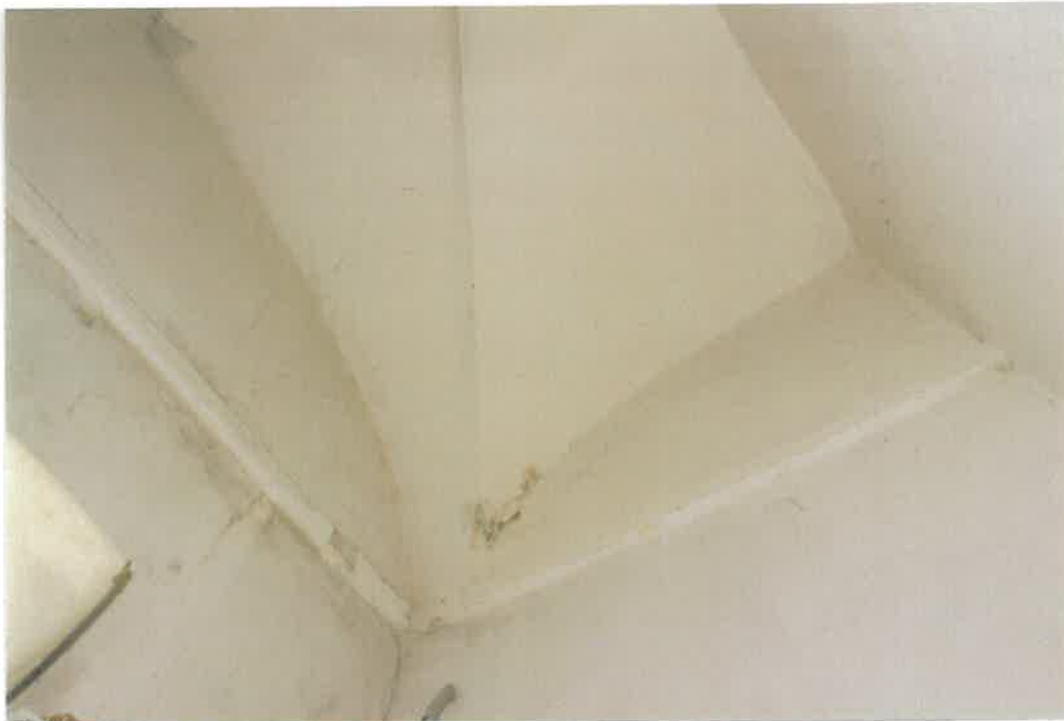
Prostora č. 1.37 - Pohled na klenbu a horní partii severní a východní stěny. V tomto prostoru je část horizontální štukové pásky lemující původně celý prostor, rozdělený dnes příčkami na prostory č. 1.36, 1.37 a 1.38. Štuková páska se nachází v partii přechodu kolmých stěn a kleneb.
