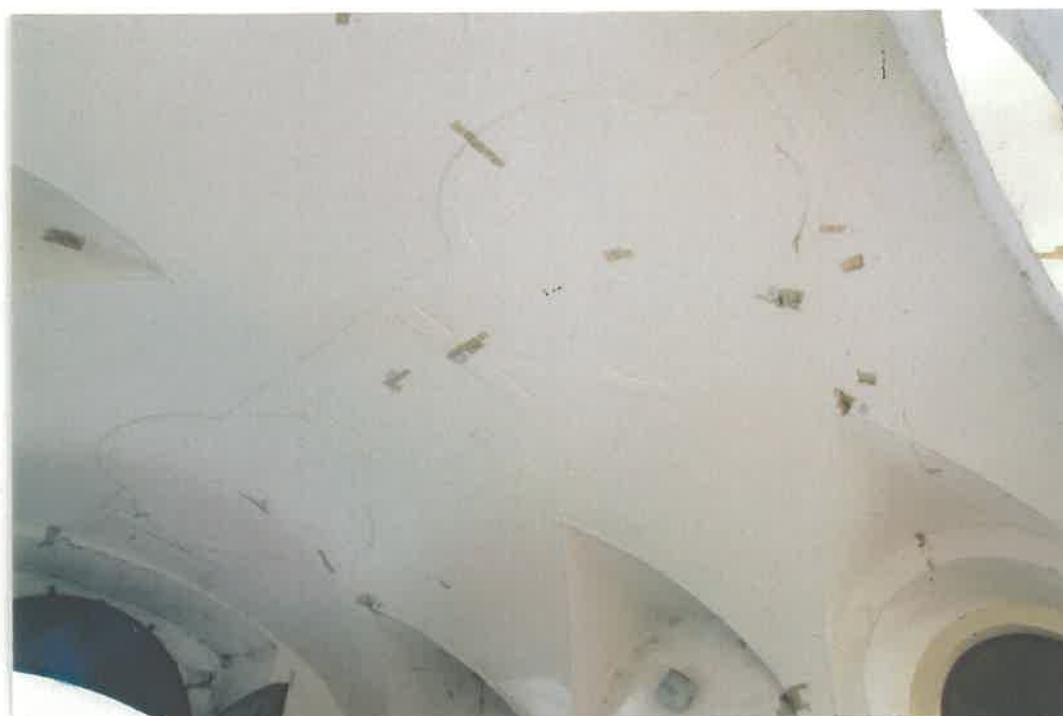
Prostor č. 1.6 (Průjezd) - Pohled na klenbu.
