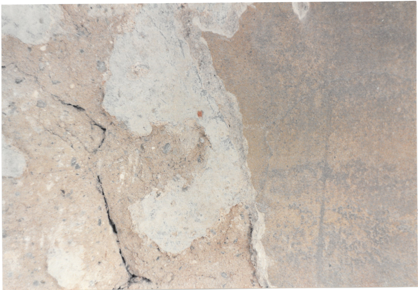
DETAIL TRHLIN PO ODSTRANĚNÍ FASÁDNÍCH BAREV AŽ NA PŮVODNÍ
