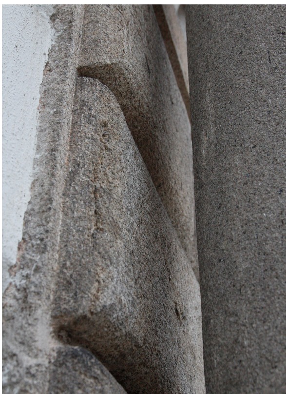
Obr. 45 Bosáž v pozadí portálu, poškození povrchu žulových prvků.
