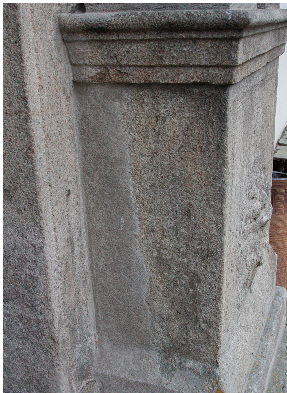
Obr. 44 Pravá strana portálu, přetmelení soklových partií.
