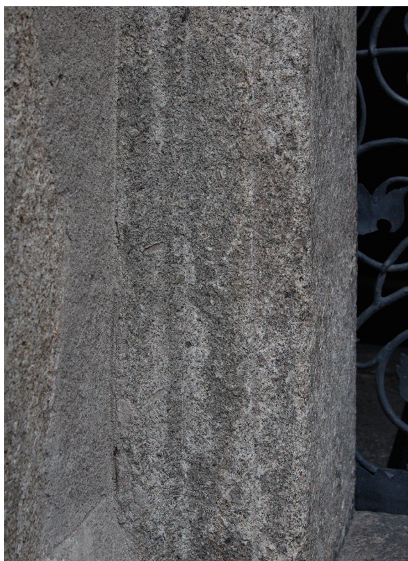
Obr. 46 Ostění portálu, poškození povrchu žulových prvků.
