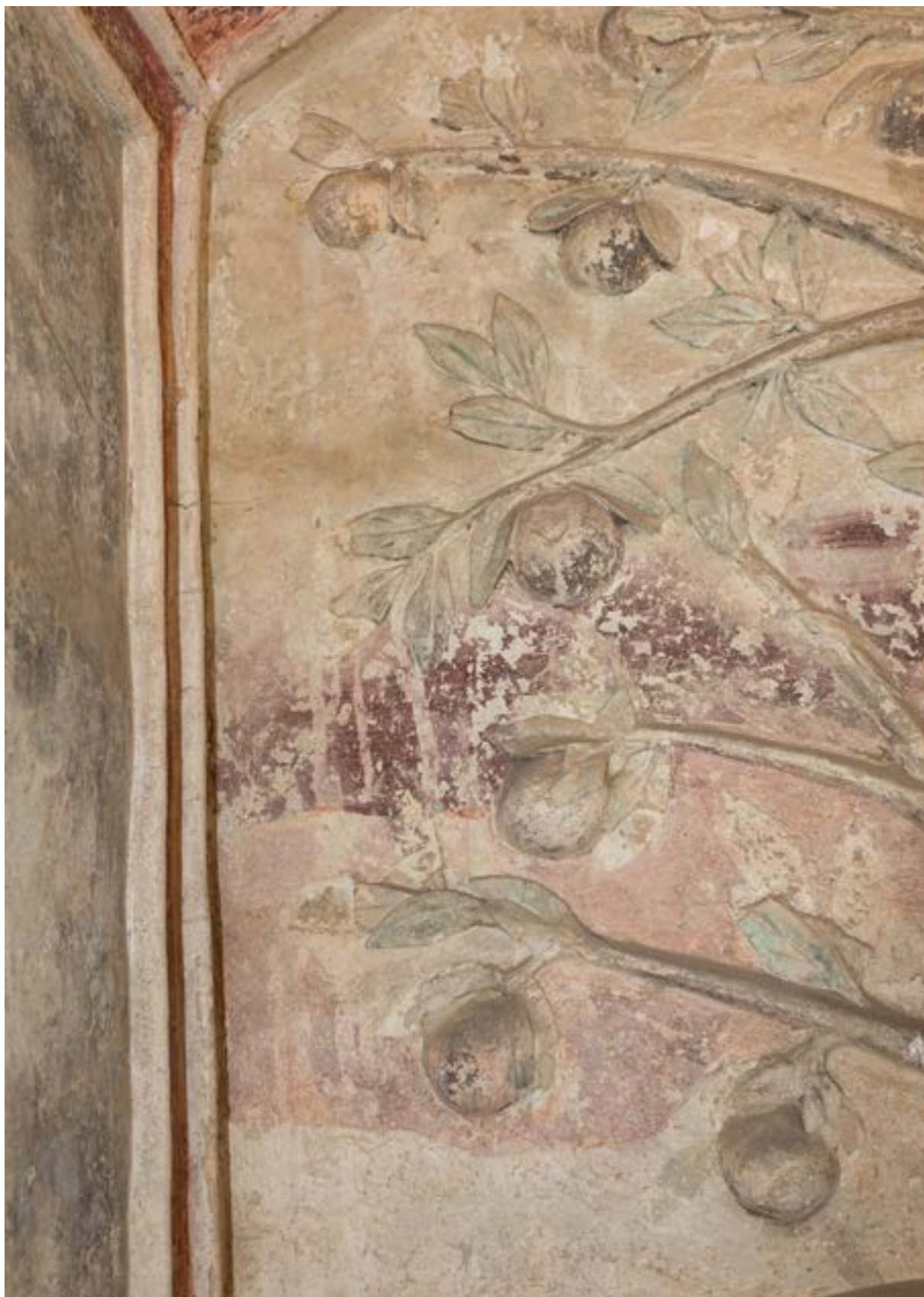
Obr. 44 Malba v pozadí výklenku. Chybějící barevná vrstva v místech, kde snad došlo k zatékání vody, nebo čisticí směsi v některé z fází oprav štuků.
