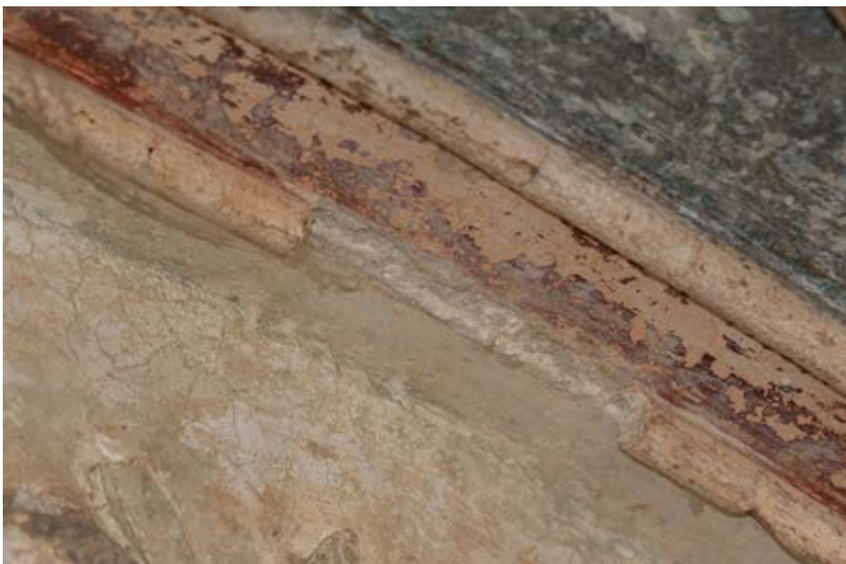
Obr. 31 Defekty v lištách okolo štukových kazet.
