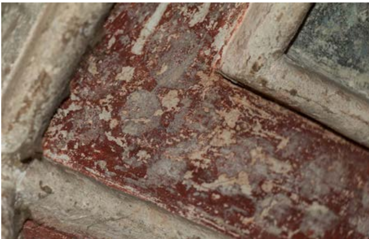
Obr. 30 Mramorování kazetových výplní v pozadí výklenku. Polychromie je poškozena zřejmě vrypy po použití špachtle na odstranění barevných vrstev.
